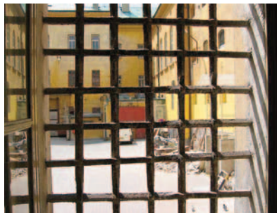
Abb. 24 Innenhof mit verschlissenem Anstrich in Schönbrunnengelb
