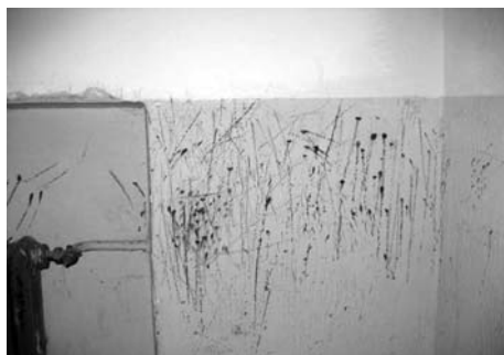
Abb. 10 Vandalismus Justizwache – Schlagstockspuren auf altrosa Wand
